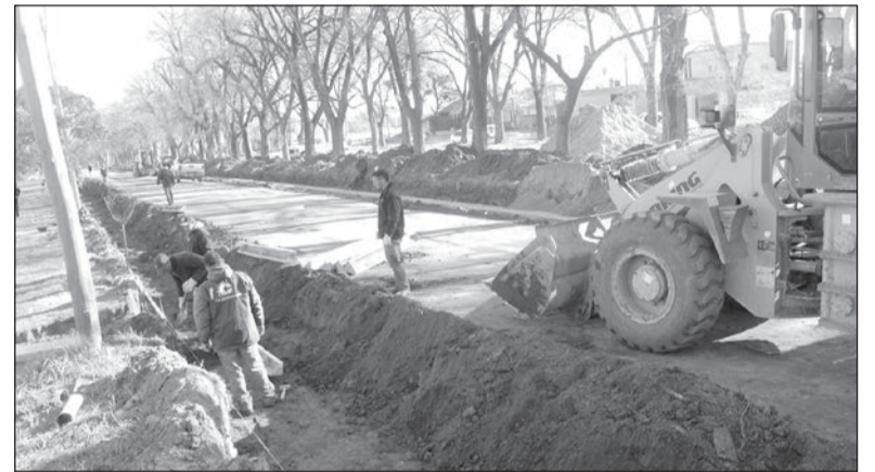
Excavación. Entre calles 83 y 85, ayer por la tarde, donde se colocarían los moldes para construir el cordón cuneta
